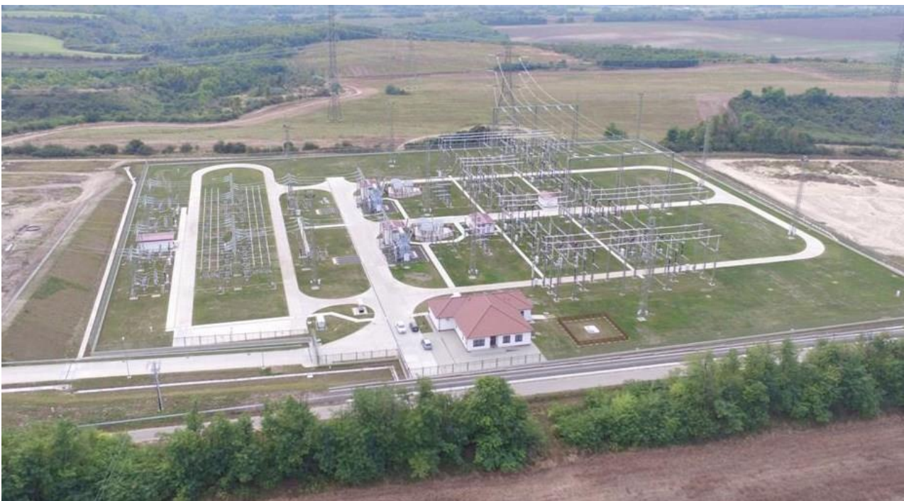
5. ábra: Kerepes 400/120 kV-os alállomás. (Forrás: MAVIR)
